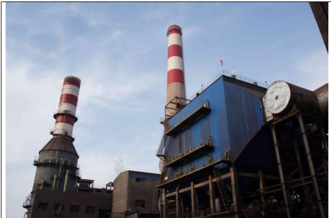
烧结机头静电除尘系统
