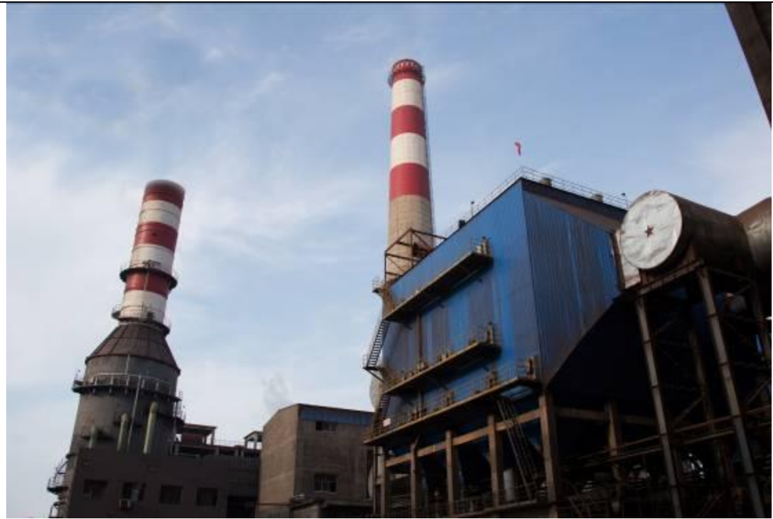
烧结机头静电除尘器
