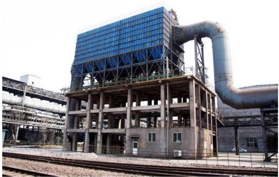
出铁场布袋除尘器
