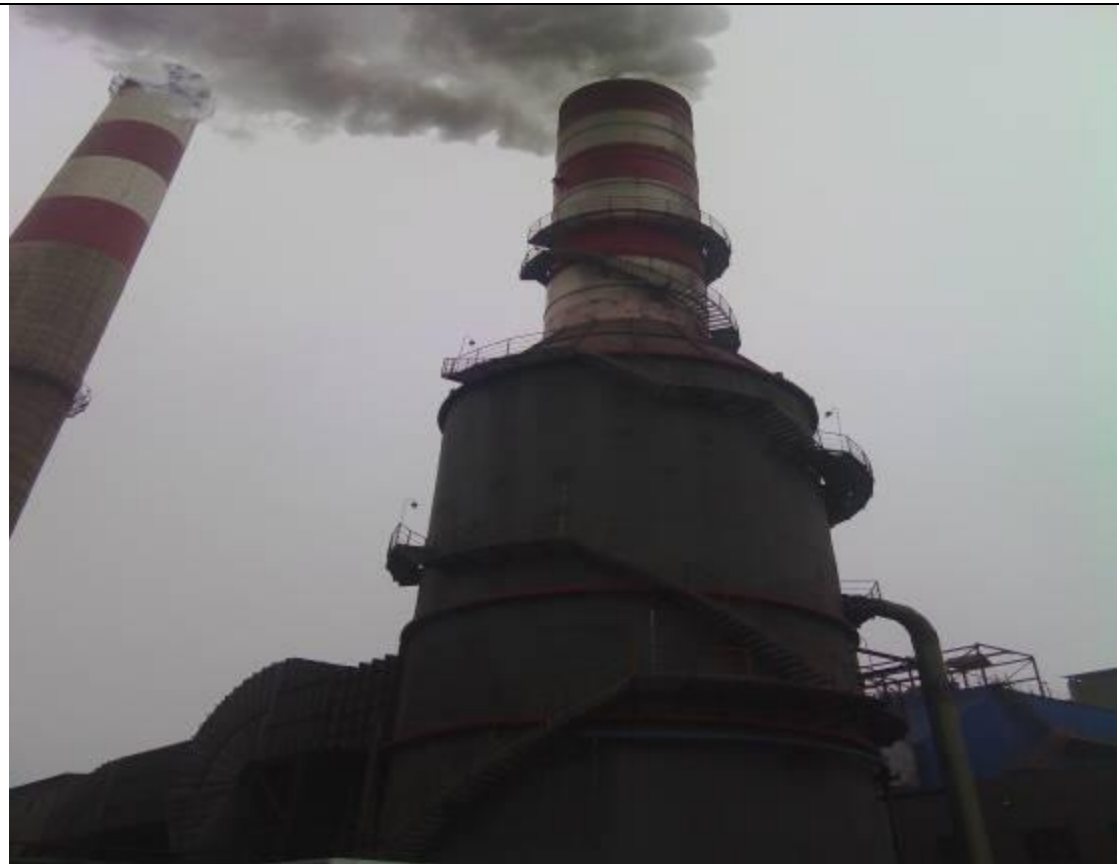
烧结脱硫装置
