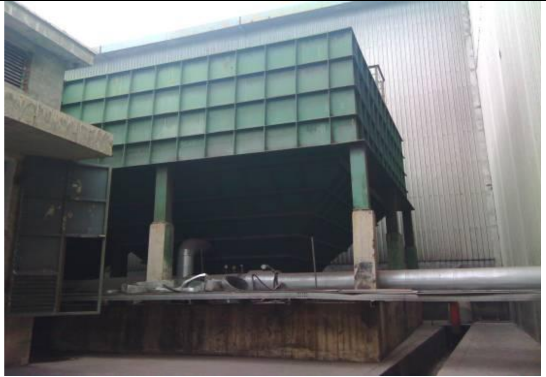
污水处理设施
