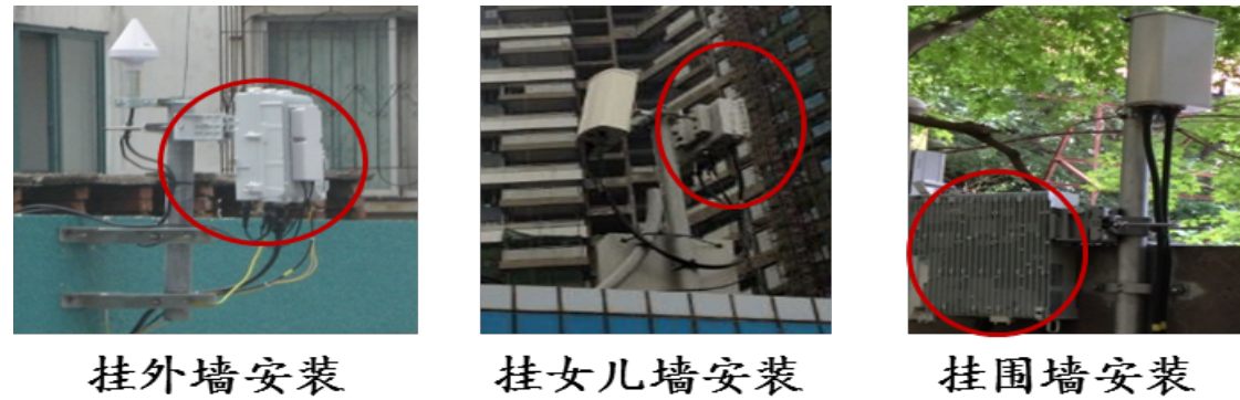
图 3.1- 2 微基站挂墙安装
