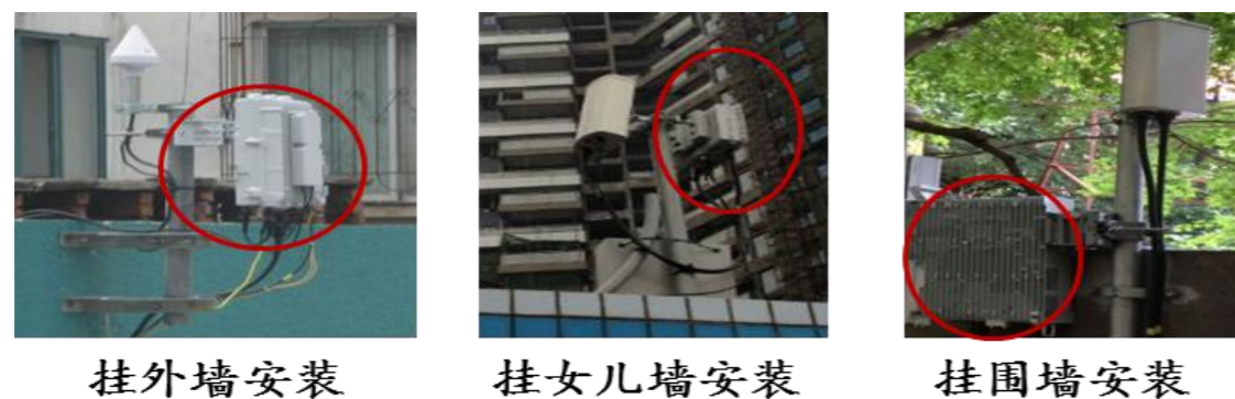
图 3.1- 2 微基站挂墙安装
